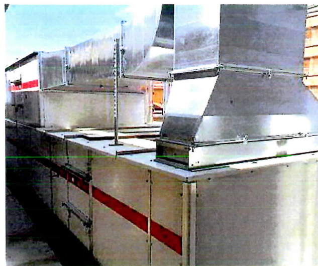
Il macchinario installato al sesto piano filtra tutta l'aria del nuovo reparto
