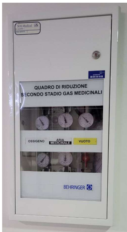
Figura 26 - Quadro gas medicinali di reparto (DEA)
